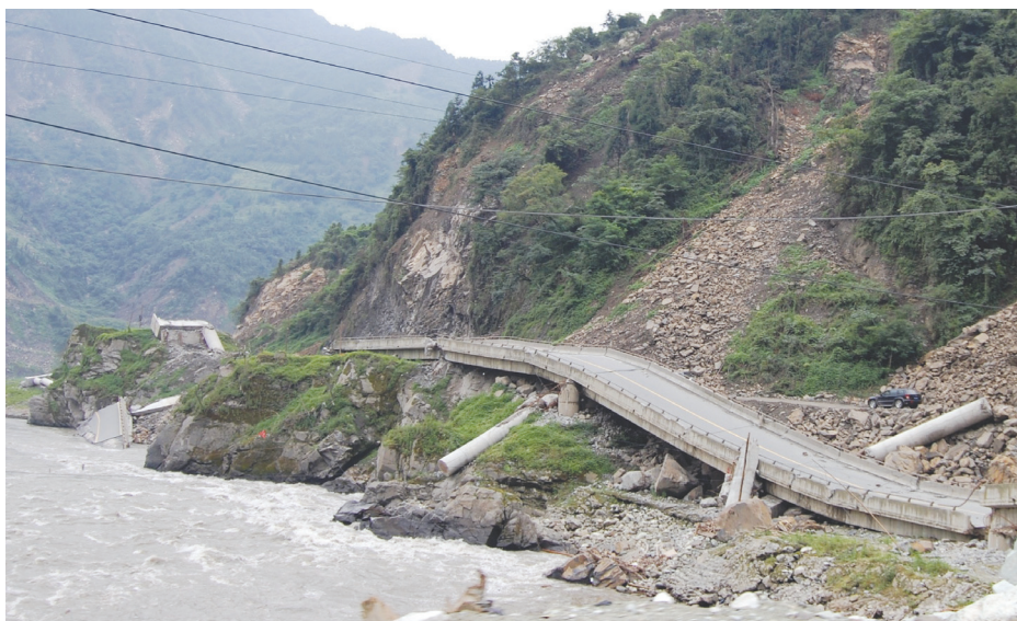
都江堰市と汶川県を結ぶ基幹高速道路が完全に陥没
