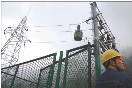
送電線の修繕も急がれていた（都江堰市虹口）
